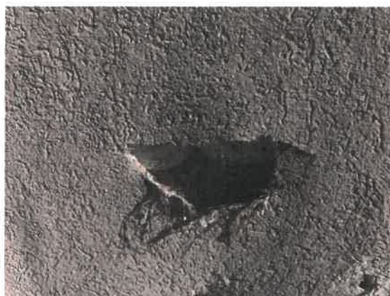
Dettaglio di uno strappo foro presente sulla facciata sud
